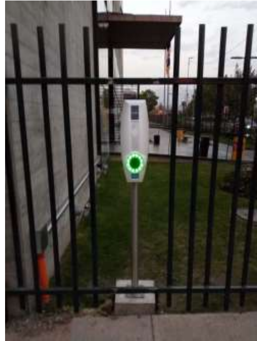
Cargador eléctrico en Edificio Comercial
