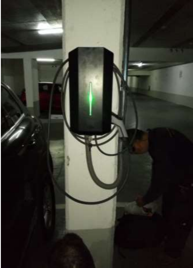
Cargador eléctrico en Edificio Residencial
