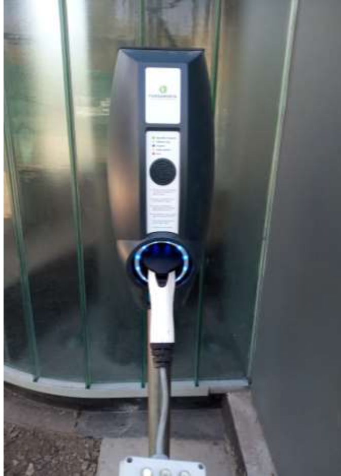
Cargador eléctrico en Edificio Comercial
