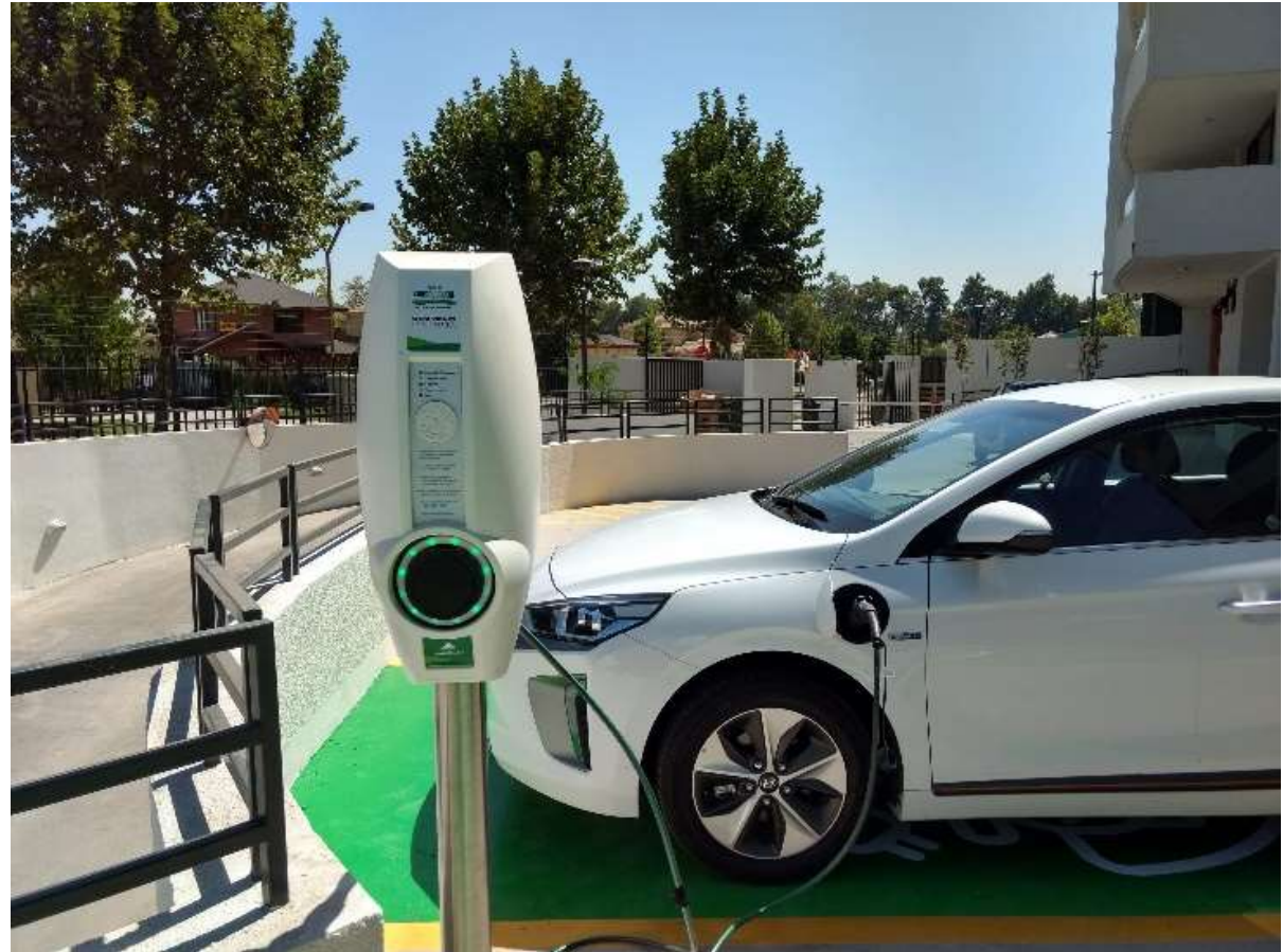
Cargador eléctrico en Edificio Residencial
