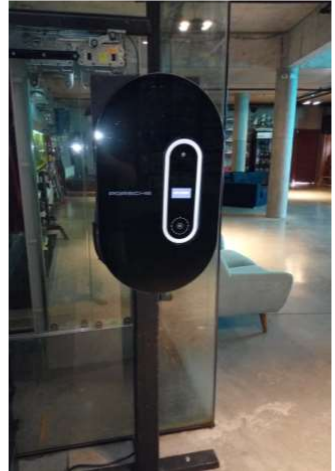
Cargador eléctrico en Locales comerciales
