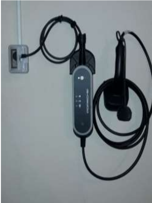
Cargador eléctrico en Edificio Residencial
